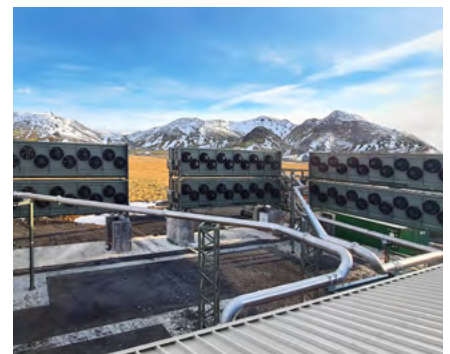
Innovativer CO 2 -Kollektor: Die hochmodernen Anlagen von Climeworks filtern Kohlendioxid direkt aus der Atmosphäre.
