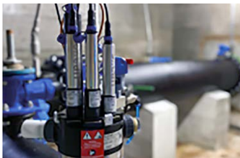
Online Mess-Sonde, Schachteinbau (Bild: Wasserversorgung Zürich)
