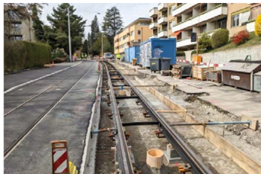
Im Zuge der umfangreichen Bauarbeiten in der Hönegger- und Limmattalstrasse wurden auch die Tramgleise und -fahrleitungen erneuert. (Bild: Katja Jauch, Locher Ingenieure AG)
