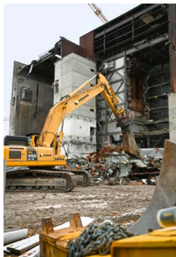
Mit der Abwärme aus der KVA Josefstrasse wurde das Netz Zürich-West fast ein Jahrhundert lang mit Fernwärme versorgt. Weil die Anlage das Ende ihrer Lebensdauer erreicht hatte und ihre Betriebsbewilligung plangemäss auslief, wurde sie 2021 stillgelegt. Die Fernwärme kommt neu aus Zürich-Nord über die neu gebaute Verbindungsleitung. (Bild: ERZ)
