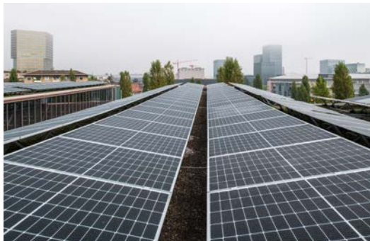
Tramdepot Oerlikon: Im Bestand weiterbauen und im Sinne von Netto-Null ergänzen. (Bild: Juliet Haller)
