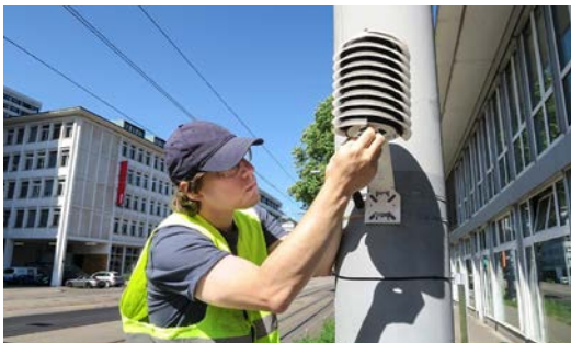
Um die natürliche Kühlung für die Stadt zu erhalten, wurden Messstationen zur Erhebung der Kaltluftströme installiert. (Bild: Thomas von Allmen)
