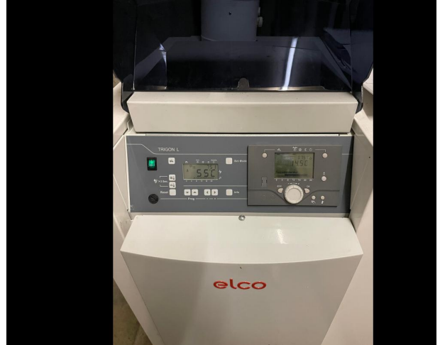
Die bestehende Gasheizung
