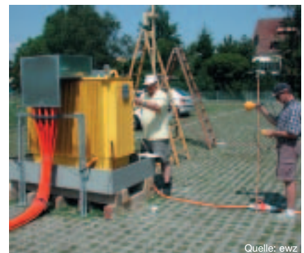
Bild 3 MS/NS-Transformator mit Anschluss-Abschirmhaube über dem NS-Kabelanschluss
